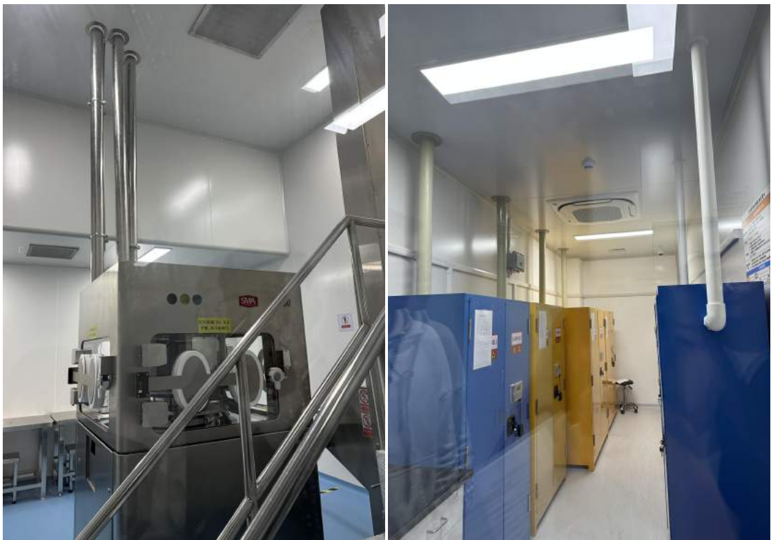
压片废气及防爆柜废气收集情况
